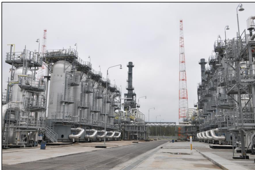
Компрессорная станция (КС) «Портовая»
